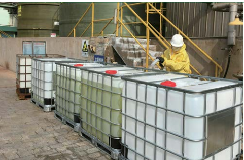
次氯酸钠消毒原液罐装中
